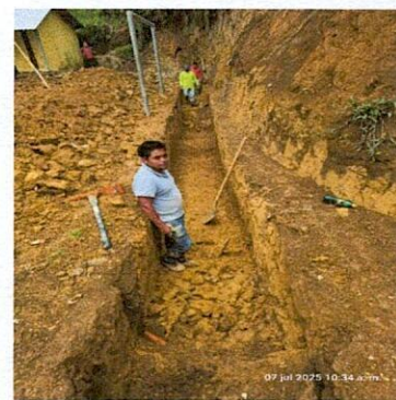
Foto 4: Retiro de Tierra debido a un pequeño derrumbe por sismo
